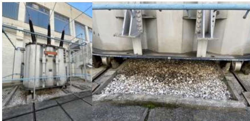
Slika 6-6 . Transformator (lijevo) i jama za prikupljanje ulja ispod (desno)
